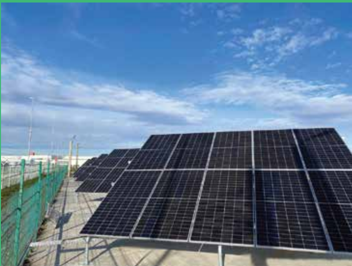
SISTEM FOTOVOLTAIC 30 KW
