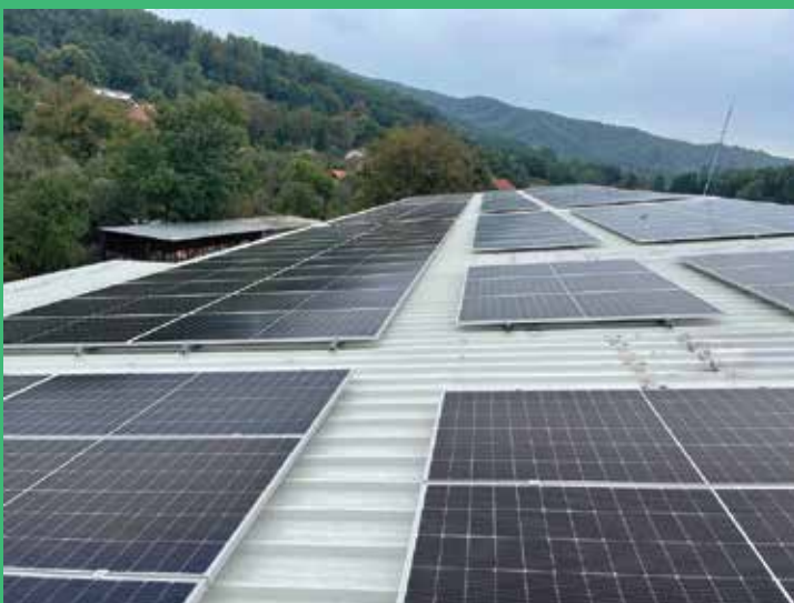
SISTEM FOTOVOLTAIC 100 KW
