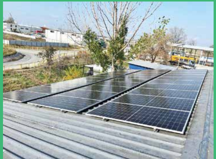
SISTEM FOTOVOLTAIC 60 KW
